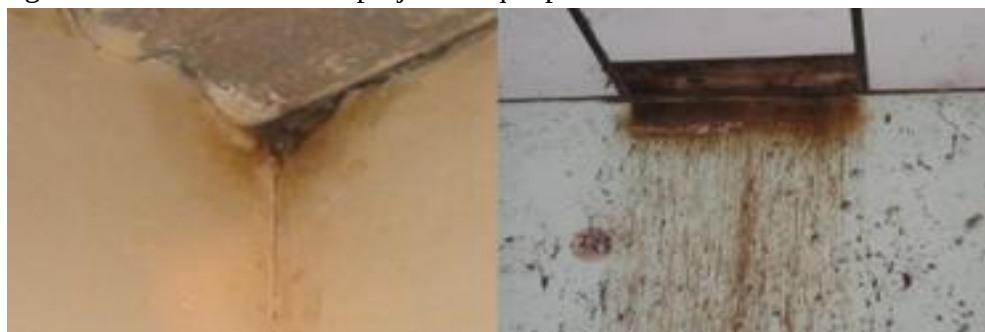
Figura 1. Deterioro del techo de inmuebles debido a las excreciones de los murciélagos. Fuente: Robin Victoria.
